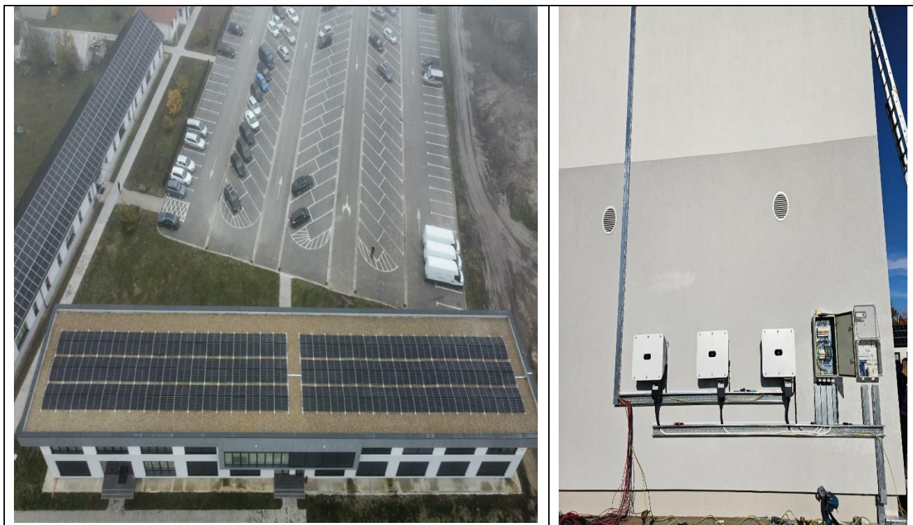
Fig. 3. Panouri fotovoltaice-Corp V3-Universitatea din Oradea
