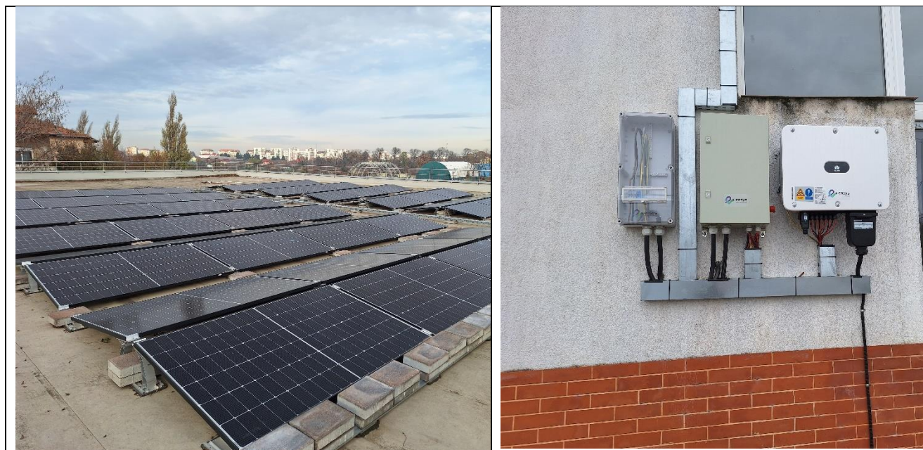
Fig. 2. Panouri fotovoltaice-Corp L-Universitatea din Oradea
